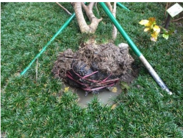
写真2. 根回しの作業が丁寧ではなく、ビニールシートを取らずに植栽
