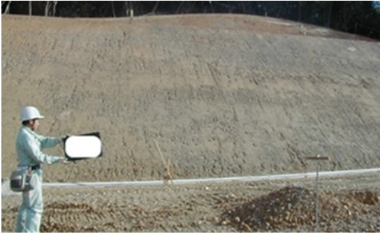
写真. 7 硫酸酸性塩土が出現した法面 (硫酸酸性塩土は海底吹上土砂だけでなく、トンネル工事や切土造成で深い位置の土壌が表面化した場合でも見られる。)
