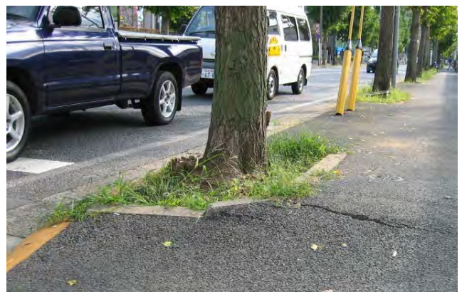
写真 2 根で縁石や舗装が持ち上がり段差が発生
