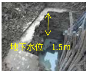
（写真7.高い地下水位）
