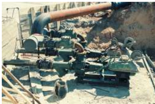
(写真7. 設計より上に設置された配管)
