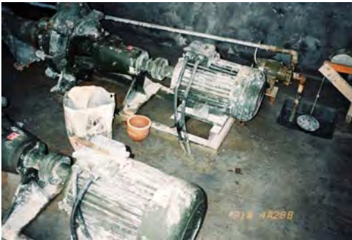
(写真 18. 循環ポンプ)
